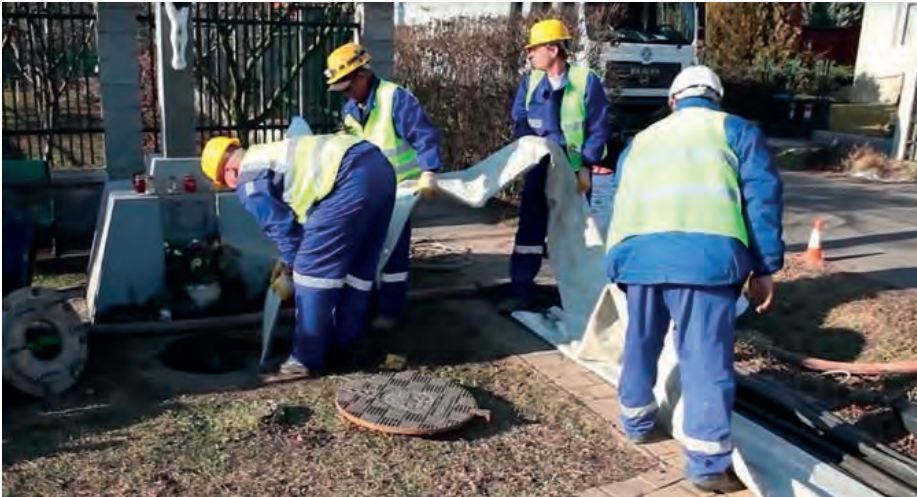
Mit dem Linersystem SoltaLiner Xtra bietet Röders ein ökonomisches und grabenloses Sanierungsverfahren, das Zeit und damit enorme Kosten spart. | Fotos: Röders
